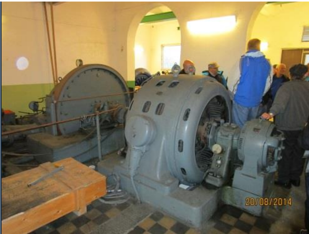
Ein nyare generator, levert av NEBB; Norsk Elektrisk & Brown Boveri.
