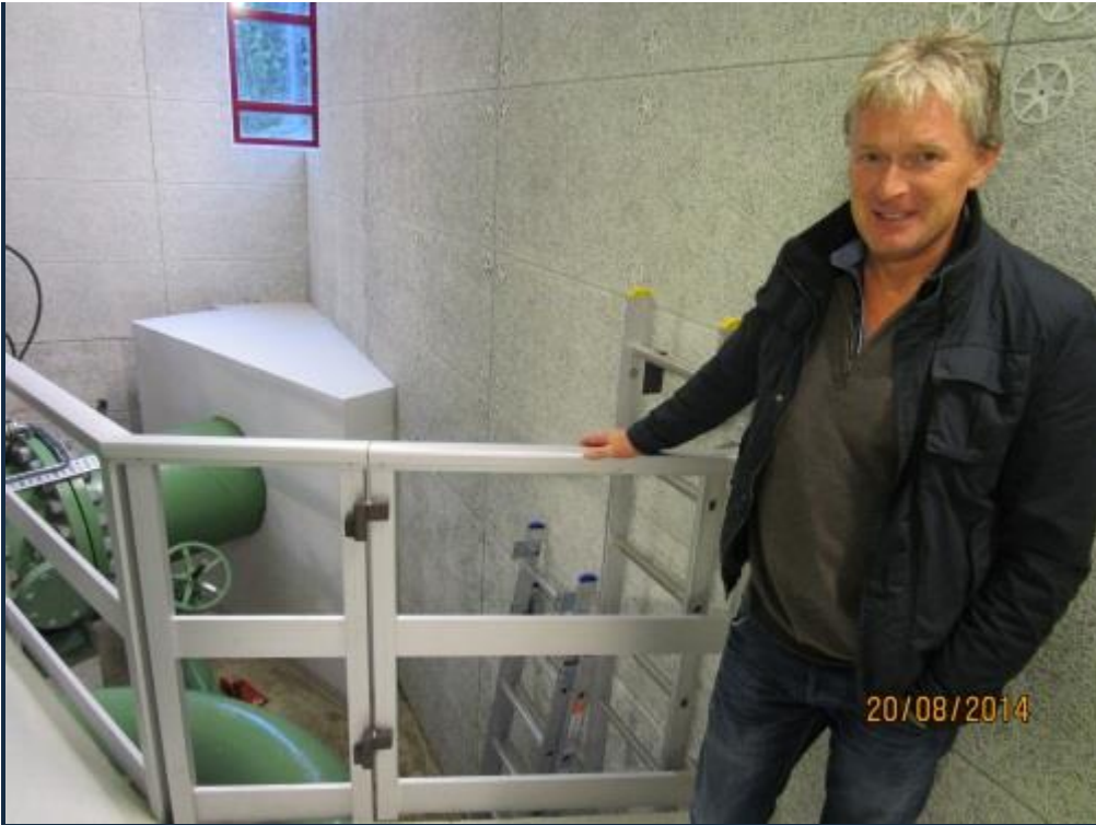
Hallgeir Lade: Det er vi som har levert og montert rekkverket/ glasveggen her!
